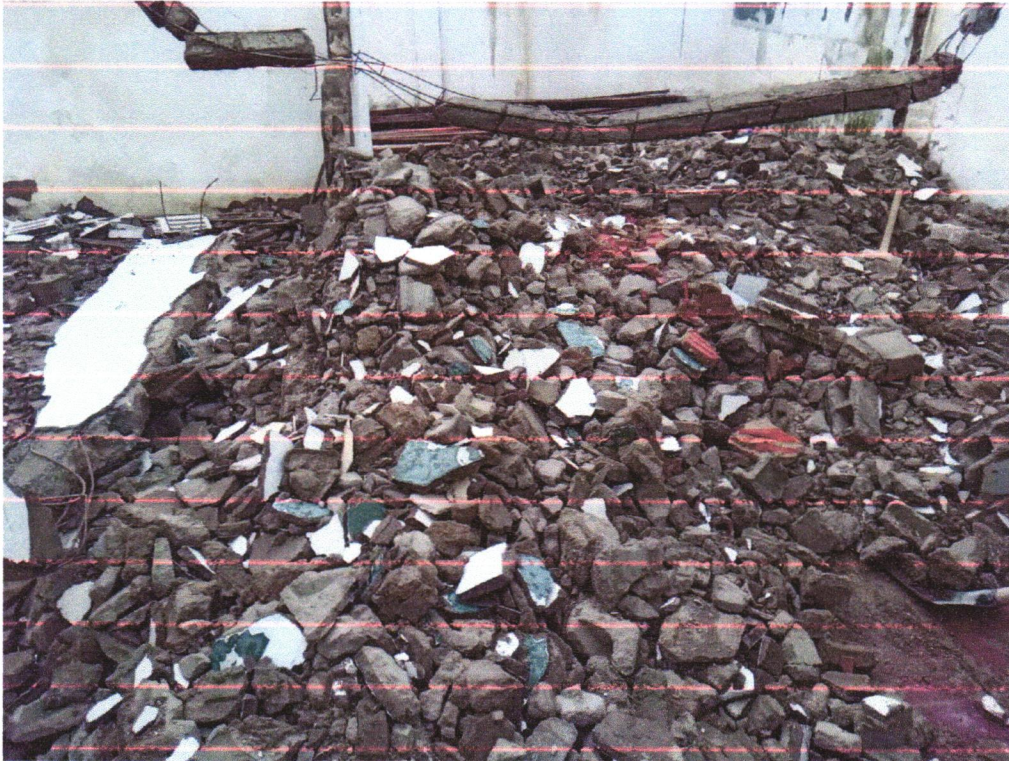
Foto 03 - DEMOLIÇÃO DE ALVENARIA DE BLOCO FURADO, DE FORMA MANUAL, SEM REAPROVEITAMENTO. AF_12/2017
